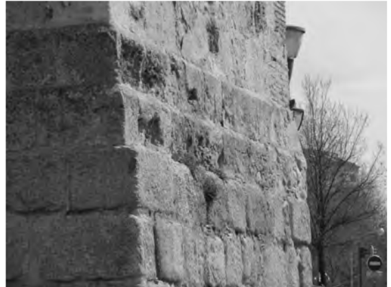
Figura 20. Detalle de zarpa escalonada en la torre T5.
