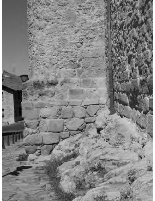
Figura 28. T7: Torre en que se conserva la fábrica de sillaría en las esquinas interiores, junto al lienzo de la muralla. Se ha perdido la sillaría de la cara frontal y de las esquinas. Denota un posible derrumbe según el plano inclinado de la figura 27, reconstruida posteriormente en mampostería. Compárese con la figura 31, aunque en este caso sólo se han redondeado las esquinas, conservando relativamente recto el frontal de la torre.
