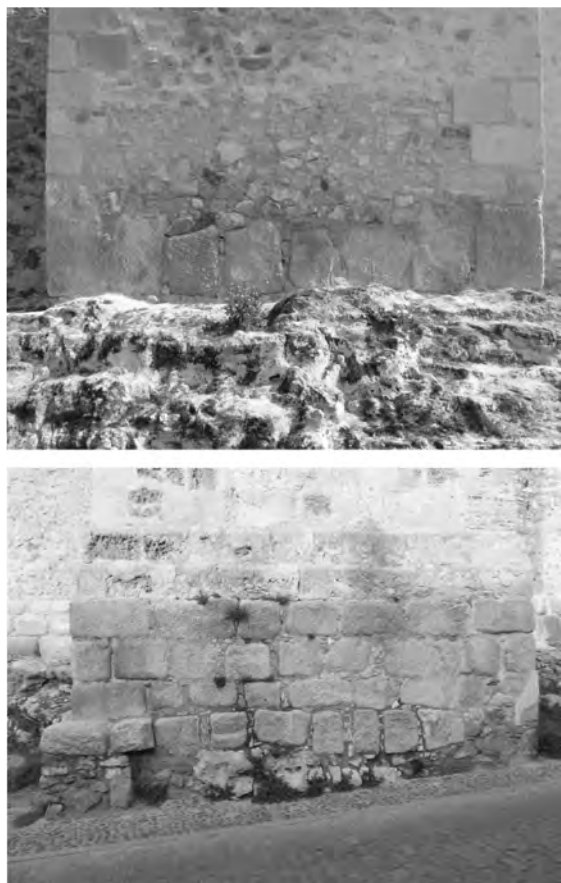
Figura 6. Sistemas constructivos en la muralla. Arriba: Torre T76. La mayoría de la muralla se construye con mampostería desconcertada, apoyada sobre un zócalo de sillares y piezas reutilizadas sin mayor intención constructiva que separarse del contacto con el terreno. Abajo: Torre rectangular T5, representativa del sector II, que en su zócalo presenta aparejo de sillería de granito reutilizada colocada a soga y tizón, organizando hiladas tendentes a la horizontal.
