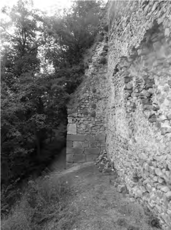
Figura 27. T51. Torre parcialmente arruinada por deslizamiento del relleno interior siguiendo el plano de rotura en ángulo.
