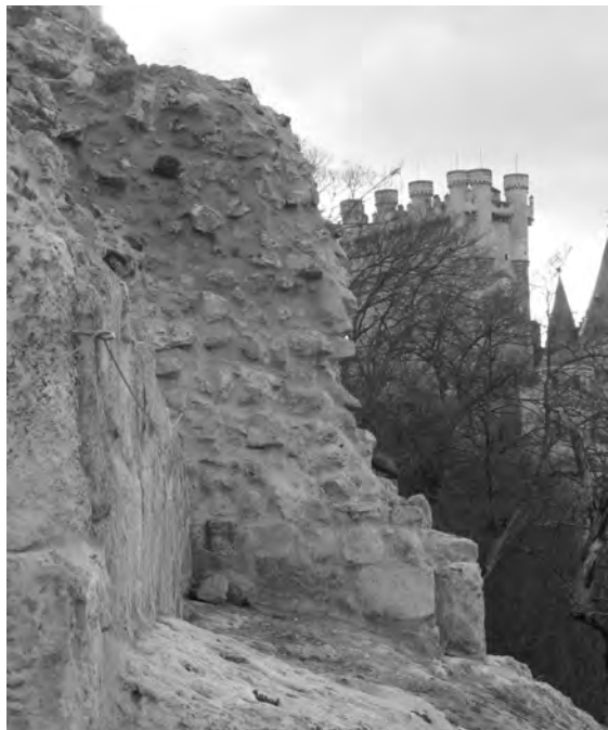
Figura 29. T61'. Resto amorfo visible del relleno interior de una torre derruida en la que se han perdido los sillares esquineros, tras los trabajos de limpieza. Nótese como se aprecia el plano inclinado de rotura y deslizamiento de la torre.
